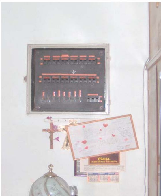
Foto N° 16. Tablero seccional sin tapa ubicado dentro de la vivienda en el primer piso.
