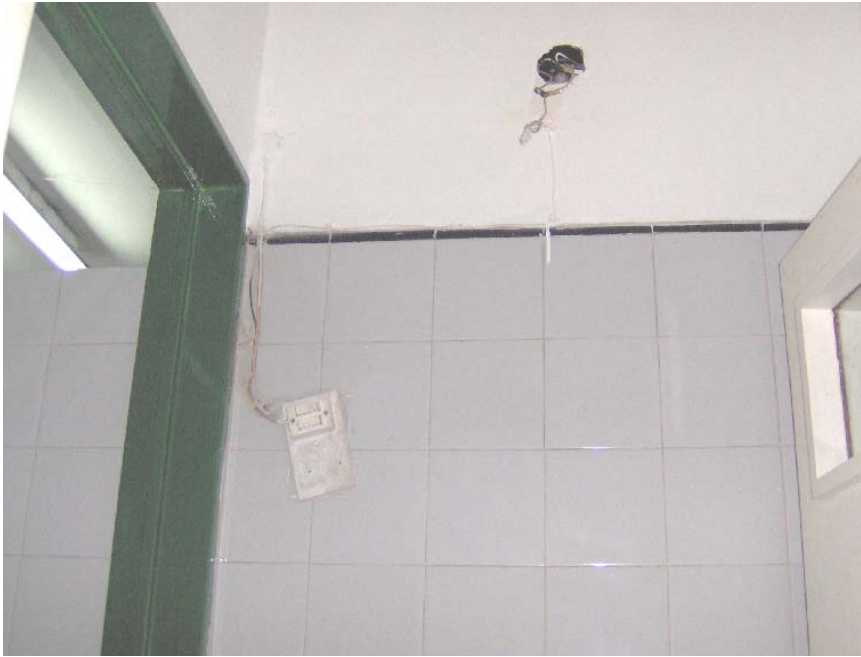
Foto N° 13 – En los baños públicos de varones en planta baja podemos observar gran desprolijidad en la instalación eléctrica: Cables expuestos y encintados con una llave de luz colocadas sobre madera y boca de luz con cables expuestos y sin tapa estos cables pasan de una cabina a otra por sobre la cuarta caña de los azulejos.
