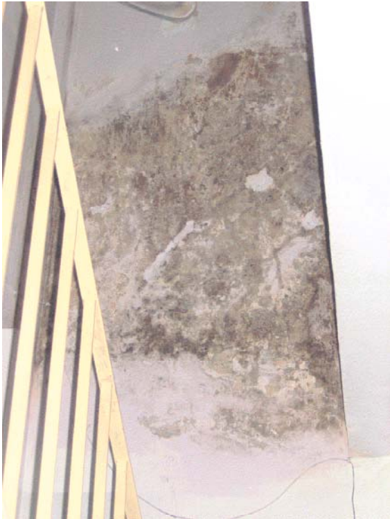
Foto N° 19. Deterioro en una pared producida por humedad dentro de la vivienda, detalle de un cable de electricidad expuesto sobre la pared. (en la escalera que sube al segundo piso).
