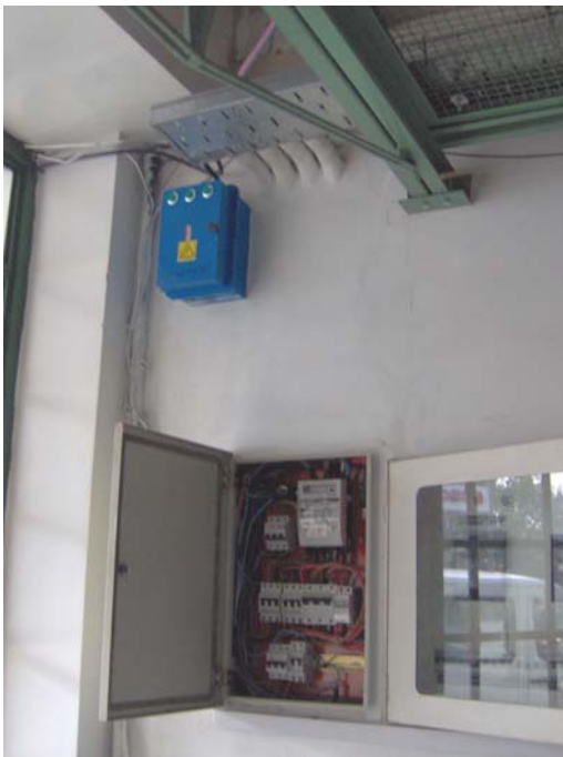
Foto N° 12 – Tablero de electricidad principal en planta baja sin contratapa con cables expuestos y en la parte superior desprolijidad en las instalaciones de sistemas y electricidad.
