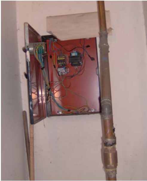
Foto N° 9 – Tablero de las bombas en planta baja sin contratapa con cables expuestos y encintados.
